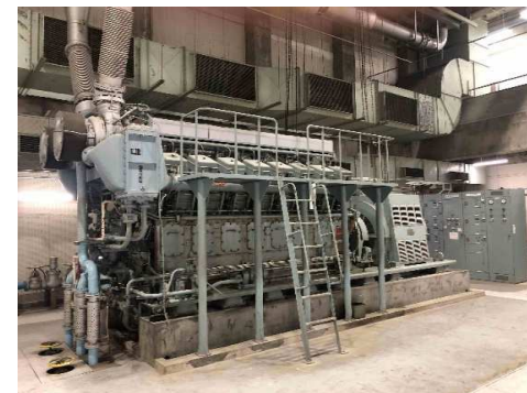
非常用自家発電設備
