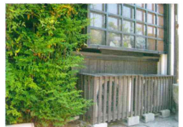
修景措置を施した室外機
