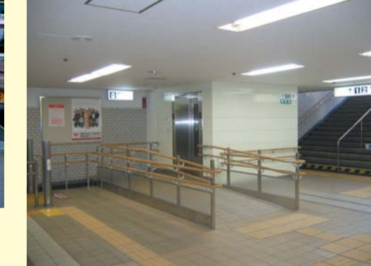
新設されたエレベーター(平成19年3月) 写真左1・2番ホーム、写真右3・4番ホーム
