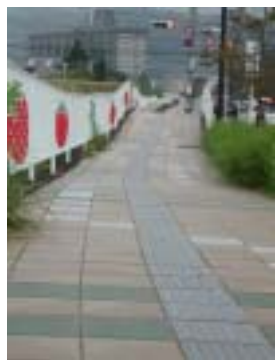
急勾配な歩道
