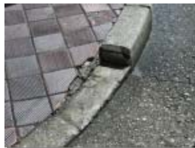
破損した歩道端
